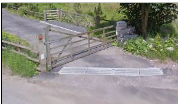
Photo 1: Bespoke highway drainage at Llanarmon Yn Ial flood investigation area
